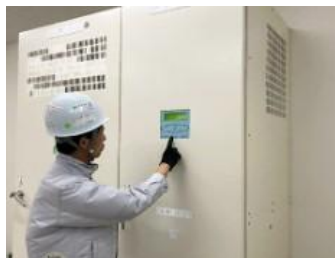
直流電源装置点検
