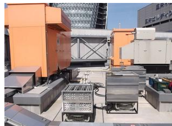
発電機負荷試験
