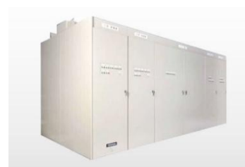
特高受変電設備
