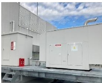
発電装置・燃料タンク
