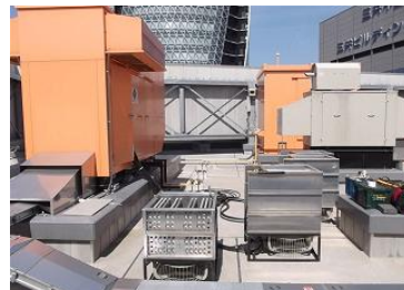
発電機負荷試験
