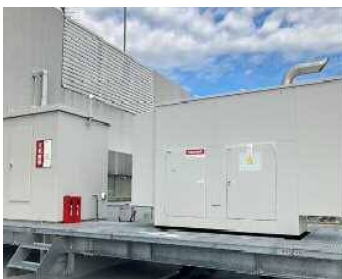
発電装置・燃料タンク
