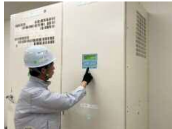
直流電源装置点検
