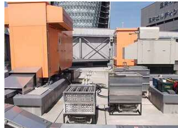
発電機負荷試験
